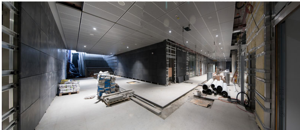
Systemy klimatyzacyjne na stacjach metra w Warszawie fot. Metro Warszawskie
