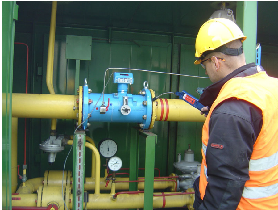
(fot. 2 Wykrywanie nieszczelności na instalacji gazowej z użyciem klasycznego wykrywacza metanu SF-321N)
