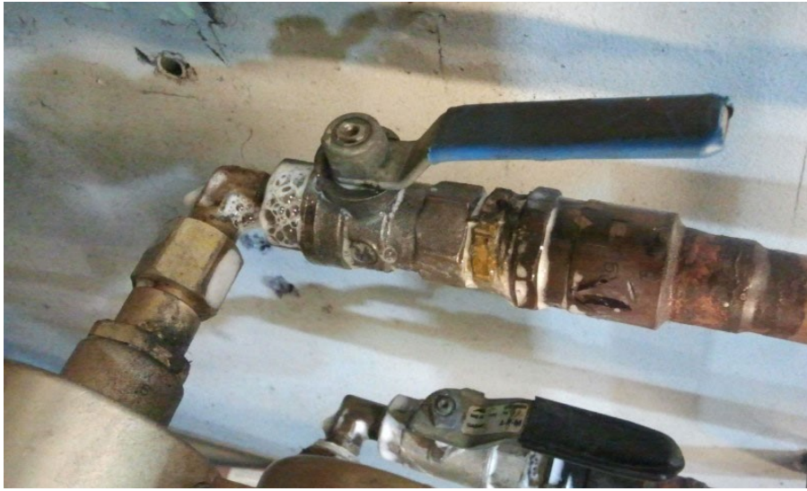
(fot.1 Nieszczelność wykryta z użyciem piany - wyraźnie widać bąble w miejscu wycieku)
